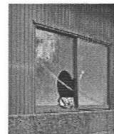
窓が割れた管理不全空家
